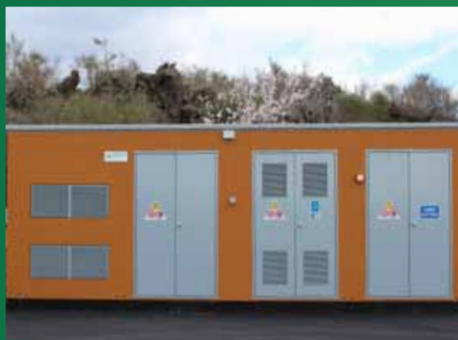
CABINE ELETTRICHE PREFABBRICATE DI TRASFORMAZIONE MT/BT
