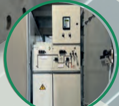
Quadro di Media Tensione
