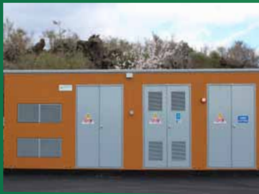
CABINE ELETTRICHE PREFABBRICATE DI TRASFORMAZIONE MT/BT
